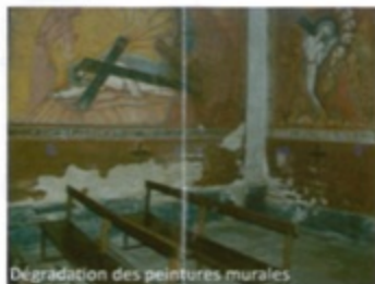
Dégradation des peintures murales
