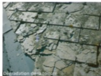
Dégradation de la toiture
