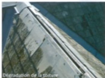
Dégradation de la toiture
